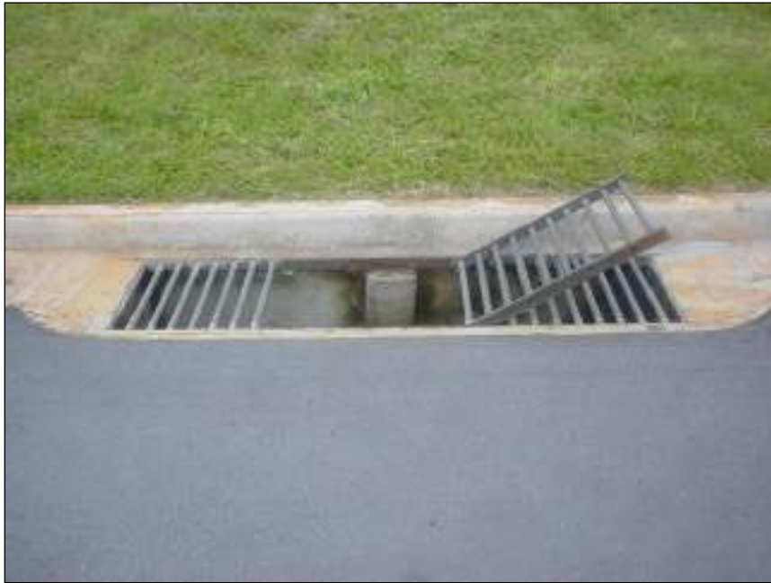
Figura 4 - Boca de lobo
